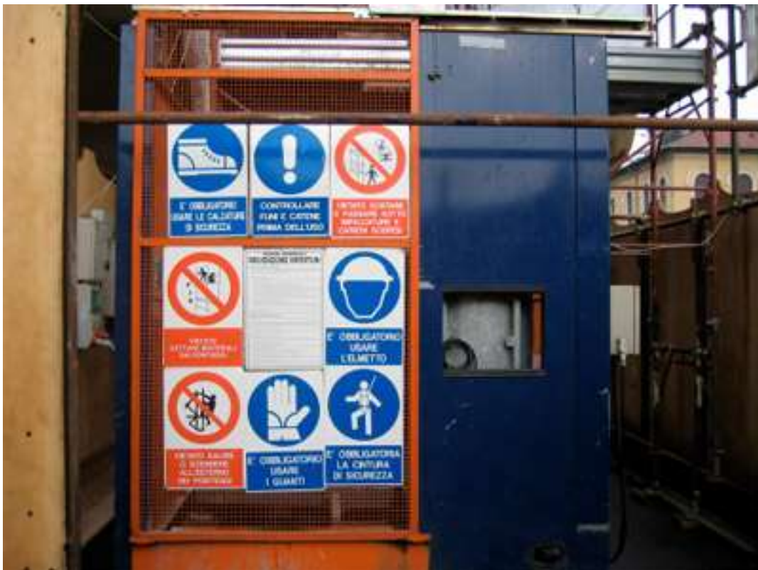
↓ L'ascensore/montacarichi di cantiere. ↓
